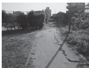
写真-1 園路の地割れ
