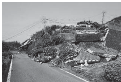
写真－3 擁壁の被害（益城町杉堂）
