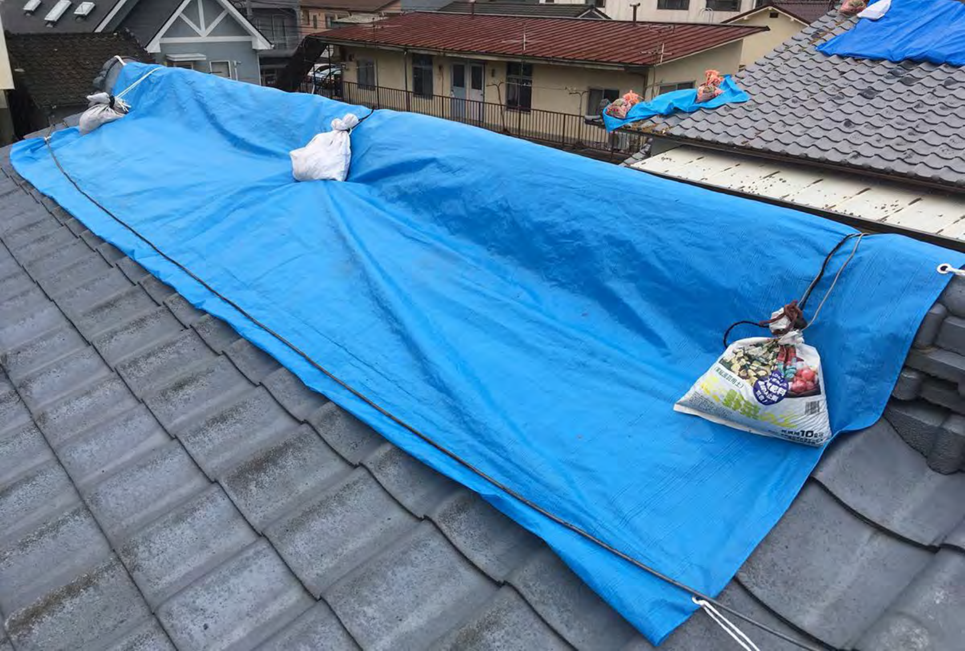
被災した瓦屋根の家屋（熊本市）
