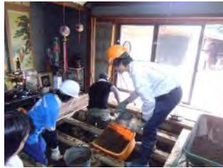
家屋の土砂撤去
